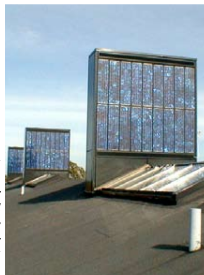
→ Bygningens ventilasjons-system er tatt i bruk til montering av solcellepaneler - en enkel og grei løsning.
