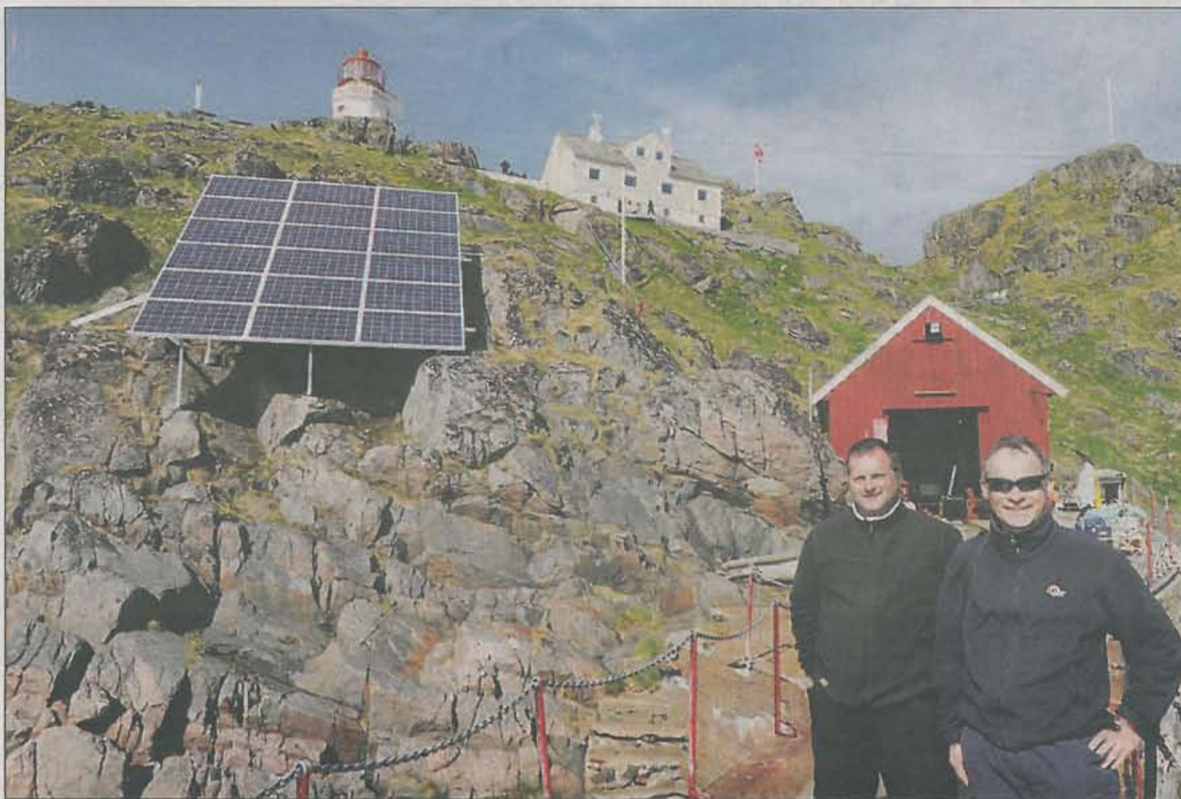
Morten Lykken Gaustad i Getek og Christian Heinlein i Rec ved panelene på Littløy. (Foto: Mareno Leonhardsen)
