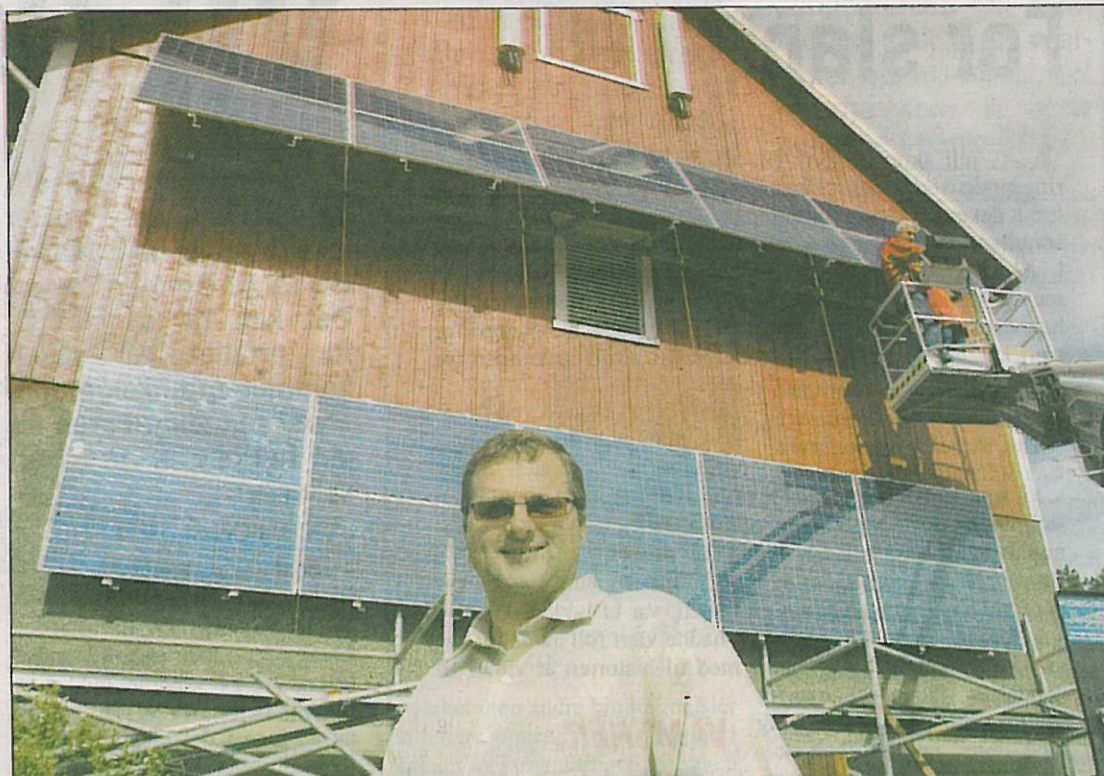
SATSER PÅ SOLA: Morten Gaustad med solcellepanelene som skal sørge for at firmaet blir selvforsynt med strøm.
